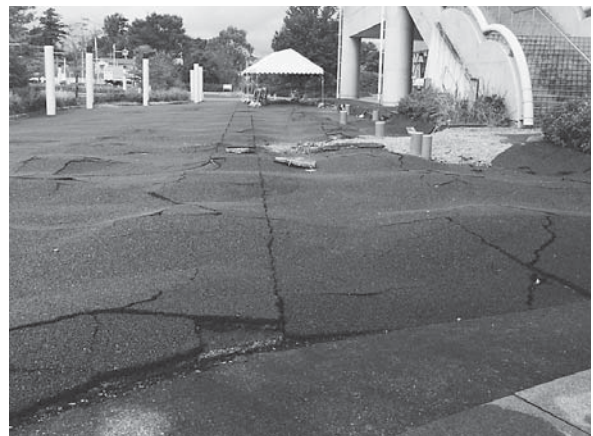
グランメッセ前の広場。 地震で液状化現象が起きている。
